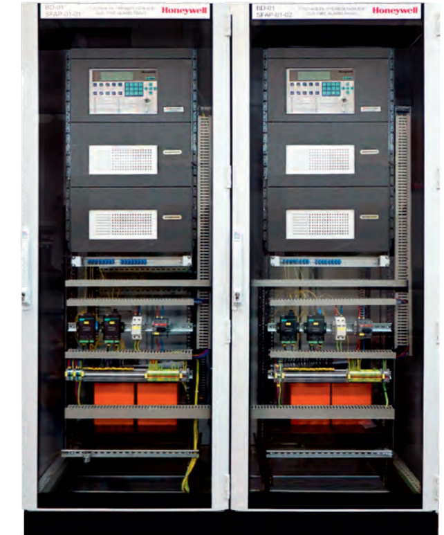
Шкаф управления автоматической пожарной сигнализацией и системами пожаротушения ОАО «ЧЕРЕПОВЕЦКИЙ АЗОТ»
