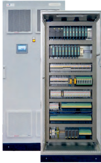
Шкаф управления линией сушки ОАО УГМК
